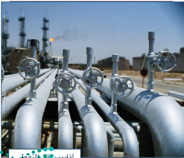
أنابيب نقل النفط
