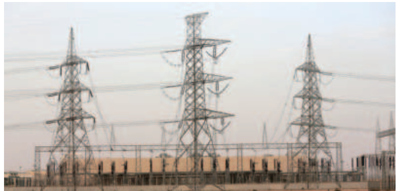
محطة سدبر لتحويل الكهرباء
